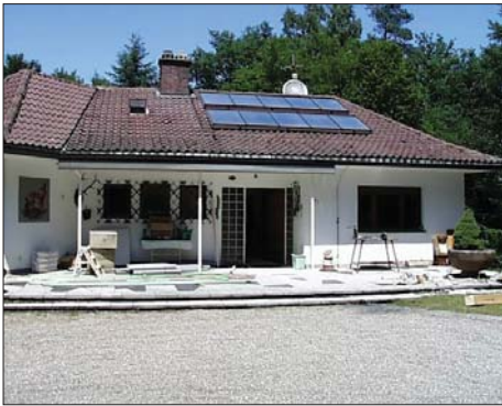
Abb. 1: Vor der Dachsanierung: Ziegeleindeckung mit unruhigem Charakter.
