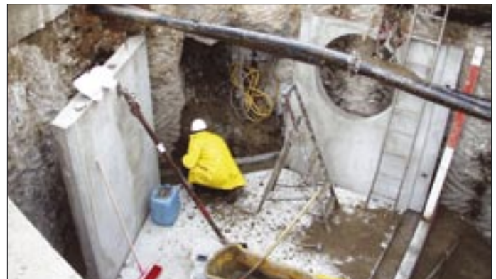
Foto: Arbeiten an der Bohrfahrwand des Abwassersammlers in Wittersheim. Die Fertigteilwände des Pumpwerkes in der Saargemünder Straße werden montiert.
