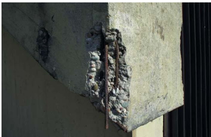
Die Schädigungen gingen bis auf die Bewehrungsstäbe.
