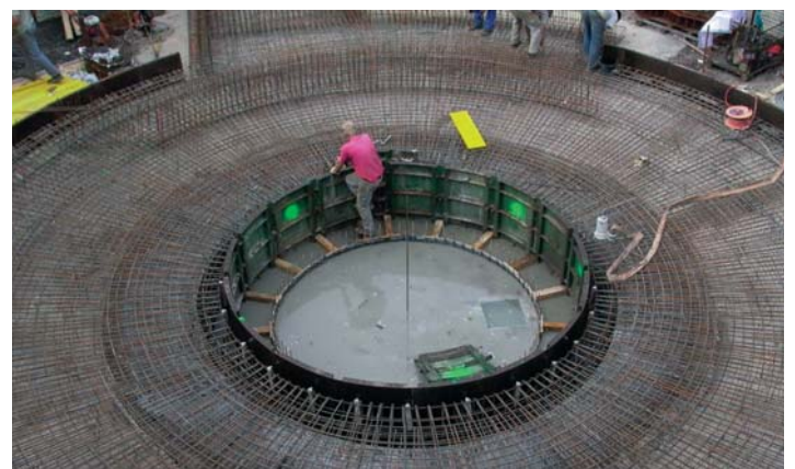
Das große Kompaktbecken bietet auch bei starken Regenfällen genügend Speicher.
