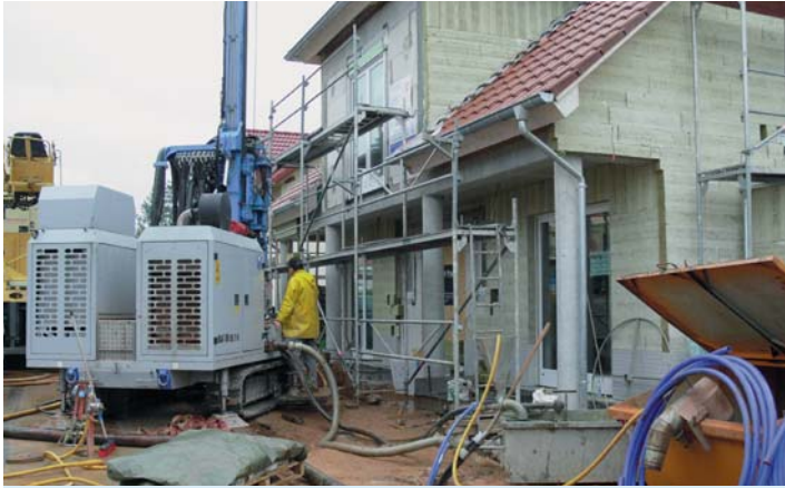
Die Bohrungen auf eine Tiefe von 80 Metern machen die Nutzung der Erdwärme möglich.
