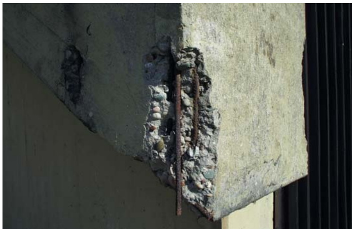
Die Schädigungen gingen bis auf die Bewehrungsstäbe.
