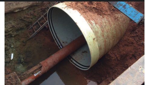
Stauraumkanal „Pfaffentalstraße“, Ommersheim
