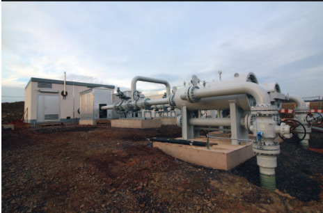
Neubau Erdgasübernahmeanlage, Merzig Creos Deutschland GmbH
